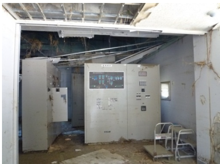
写真-1 津谷街浄化センター 電気設備
