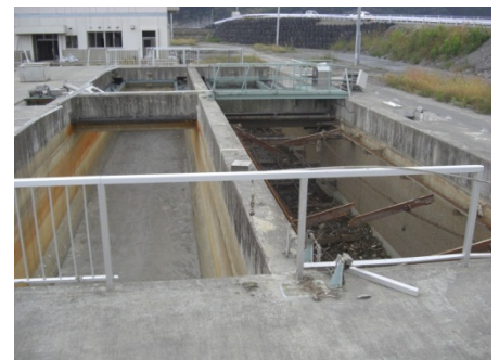
写真-3 陸前高田浄化センター 最終沈澱池
