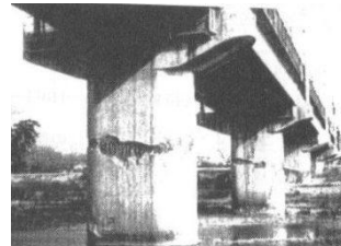
写真-1 衝撃的な上下動によって生じた輪切り状のひび割れ破壊 1)
