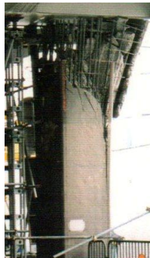
写真-4 柱上端の破壊・鉄筋籠の残存と透視 11)
