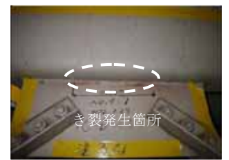
図-6 損傷部写真
