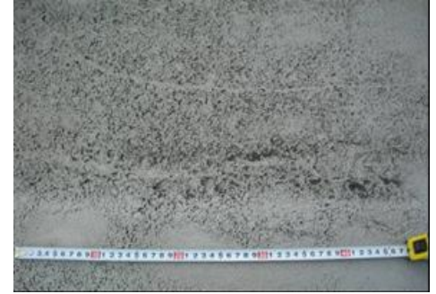
図 1 デッキプレートの腐食例
