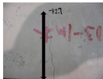
図3 治癒前ひび割れ深さ
