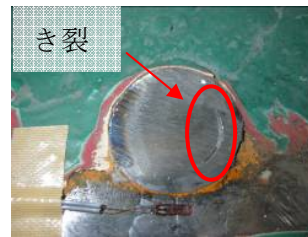
写真-4 き裂状況
