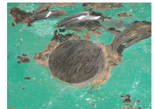
(b) 損傷あり
