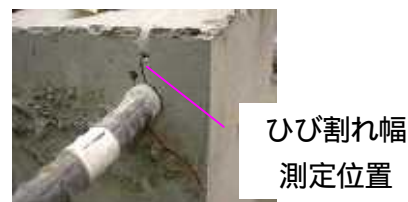
図 3 ひび割れ幅測定位置
