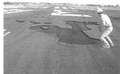
写真-1 滑走路の損傷事例
