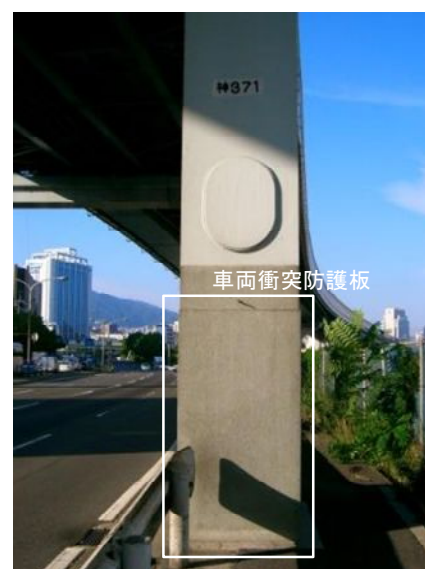
写真-2 車両衝突防護板
