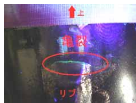
写真-2 標準タイプの亀裂
