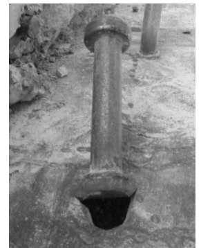
図5 スタッドのめくれた底鋼板
