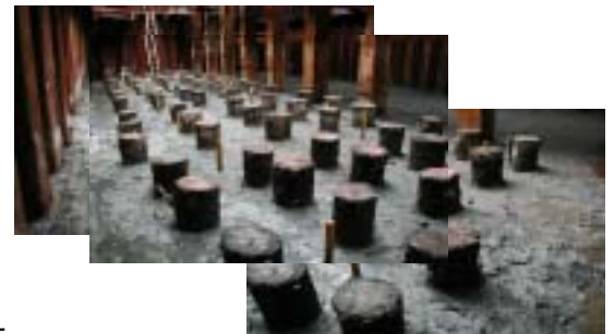
写真 - 1 杭頭の露出状況
