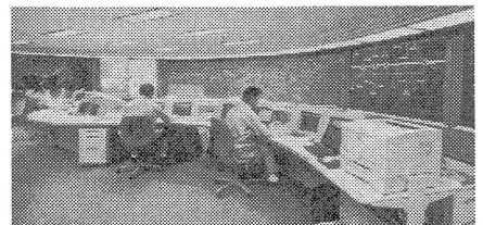
大阪ガス 中央保安指令部
