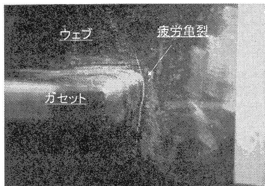
写真-1 発見時の疲労亀裂 (SM570Q 1 体目 B 断面 Nd=443 万回)
