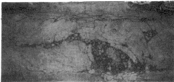
写真1 床版上面の破碎状況
