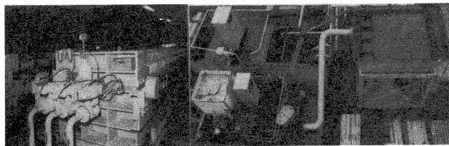
写真5 F.P.装置 写真6 放流水管理装置
