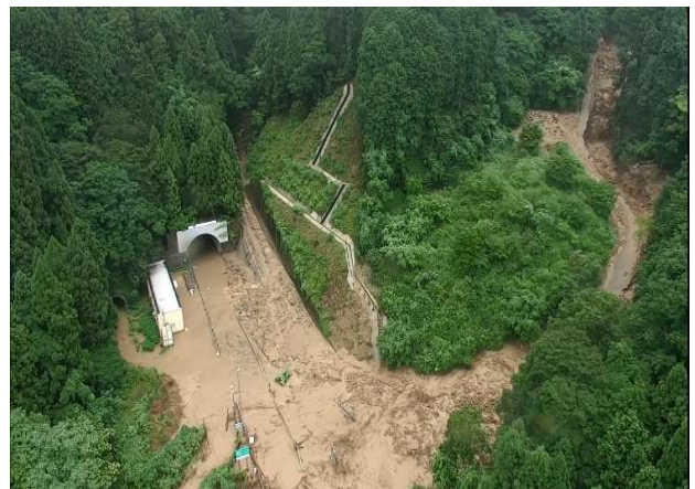
写真-1 下り線敦賀トンネル南坑口被災状況
