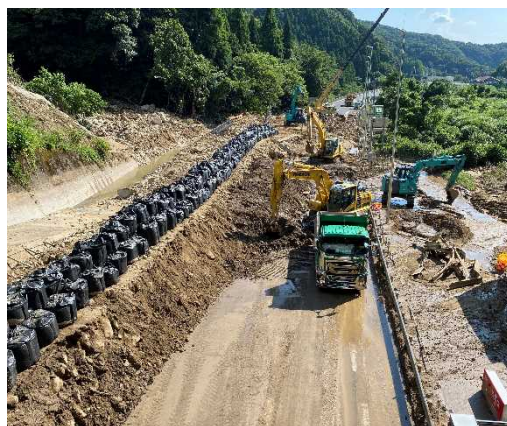
写真-1 下り線敦賀 TN 南坑口部土砂堆積状況
