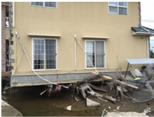
写真-1 洪水氾濫流による住宅の洗掘被害
