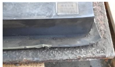
図-1 ゴムダンパーに発生した剥がれ
