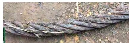
図5 ワイヤー素線断裂状況
