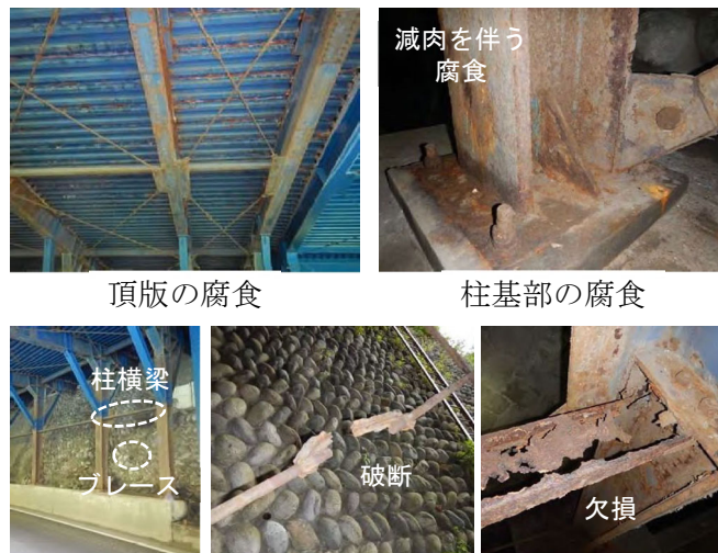
写真-1 鋼製シェッドの損傷状況
