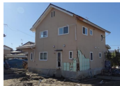
写真-2 流失家屋②
