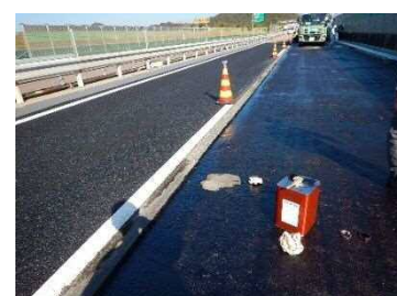
写真-5 既設路面からの浸み出し
