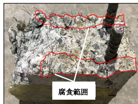
図-8 ひび割れ面の腐食状況
