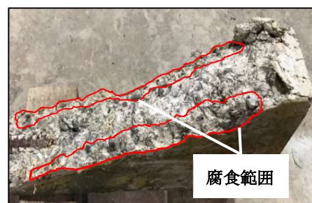
図-7 ひび割れ面の腐食状況
