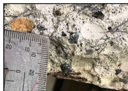
図-9 ひび割れ面の腐食状況
