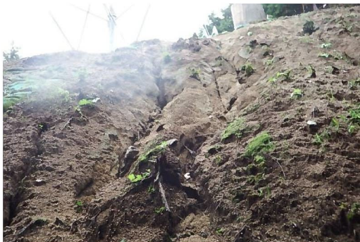
写真1 雨裂ができた斜面浸食例
