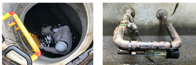
図-1 水位計設置の様子
