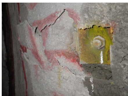
写真-2 吹付け耐力不足 ロックボルトプレート破断・変状状況
