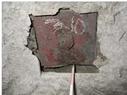
写真-1 吹付け耐力不足
