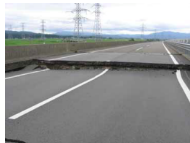
図 1 中越沖地震で発生した路面段差 1)
