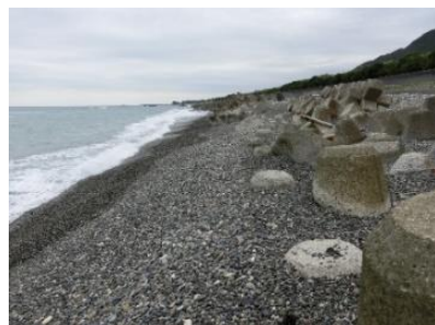
写真-1 三重県七里御浜海岸に設置された消波ブロックの埋没状況
