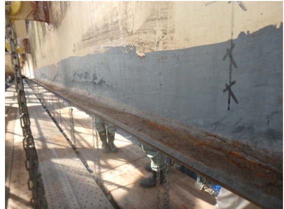
図-1 トラス橋下弦材の腐食状況例
