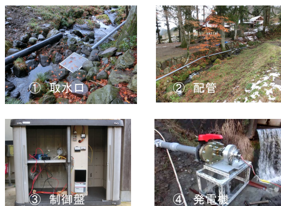
図-3 ピコ水力発電の設置状況（寒水漆洞谷）
