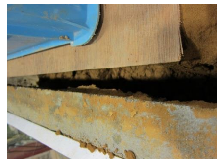
写真1 盛土と壁体の間の隙間
