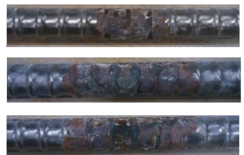
図-2 鉄筋の腐食状況
