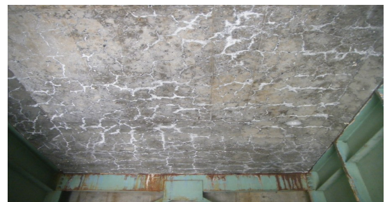
写真-1 床版のひび割れ状況
