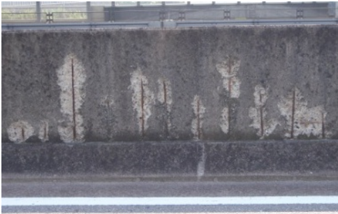
図-1 対象とした壁高欄の劣化状況
