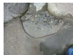
写真-6 右岸側の欠損箇所
