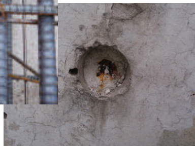
写真-2 穴埋めモルタル部落下状況
