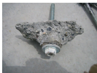
写真-8 突起上部で躯体破断
