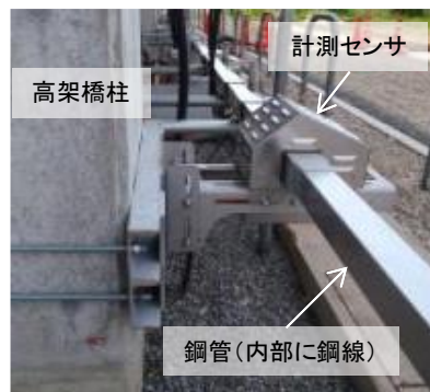
写真-1 ラインゲージセンサの設置状況
