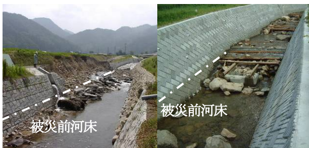
写真-1 改修済中小急流河川における河道災害の例 (平成16年台風第23号出水、岐阜県飛騨地方)
