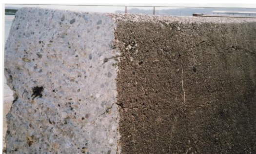
写真3 横ひび割れの深さの1例
