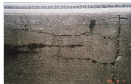
写真2 縦・横ひび割れ発生
