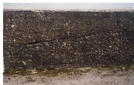
写真1 横ひび割れのみ発生
