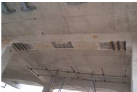
写真-3 縦梁損傷状態
