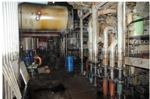
写真-1 津波を受けた Satala 発電所の内部
