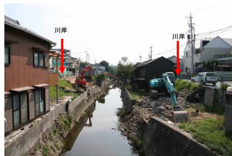
写真-1 中橋下流河道内住宅(2008/09/15)
