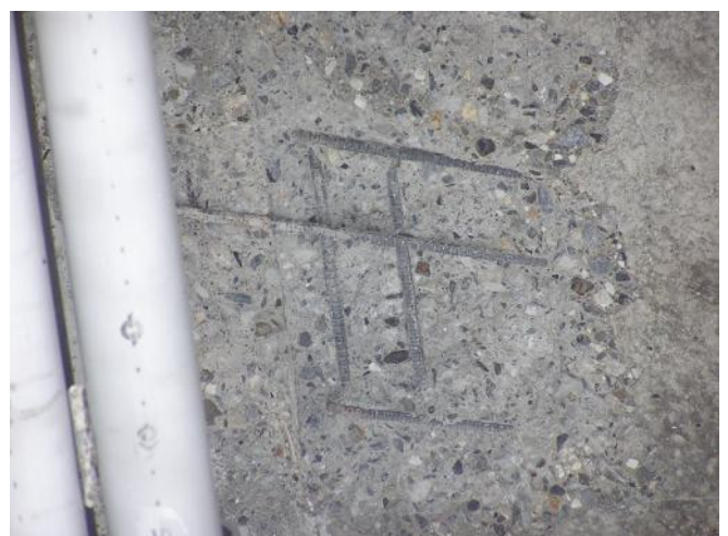
図2. 床版の剥離落下による鉄筋の露出
