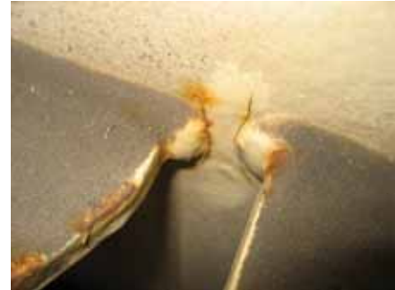
図 - 1 鋼橋に発生した疲労き裂
