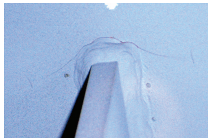
図-1 垂直補剛材上端部に発生する疲労き裂
