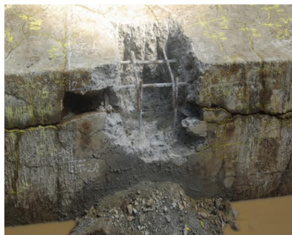
写真-1 フーチングに発生した定着長不足による割れ
