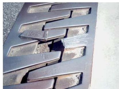
写真1 フィンガーの破損事例
