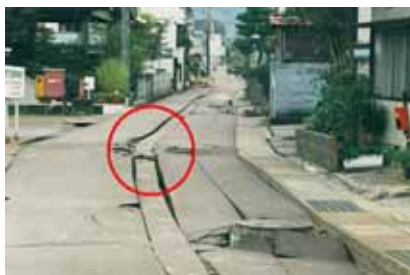
写真 1 消雪管の破断
